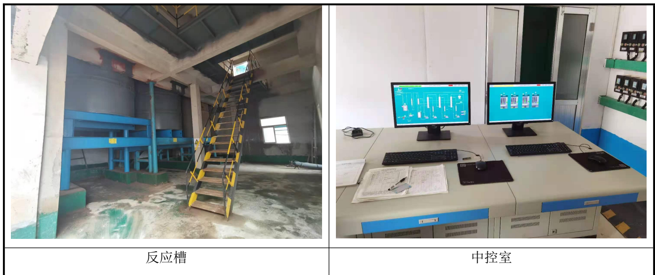
图 3-4 项目现场设备设施
