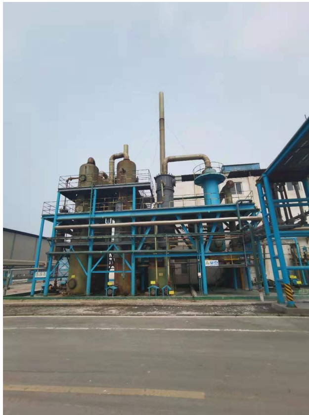
图 4-1 项目废气治理设施
